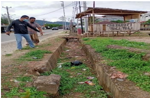
Gambar 4 kondisi jaringan drainase pada lokasi penelitian
